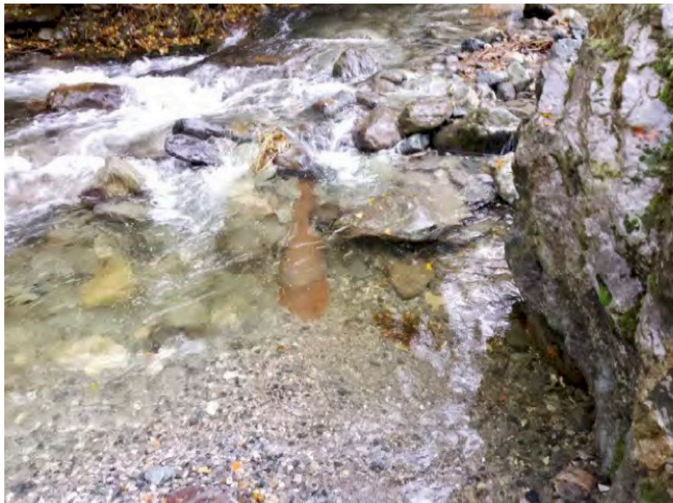
Fig. 2: Porzione di tubazione scoperta in alveo
